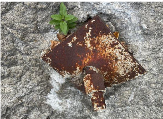
Abb. 6 Korrosionsschäden an der Nagelkopfausbildung einer Spritzbetonkonstruktion
