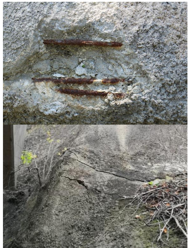
Abb. 7 Konstruktive Schäden Spritzbetonkonstruktion, freiliegende und korrodierende Bewehrung (oben), horizontaler Riss (unten)
