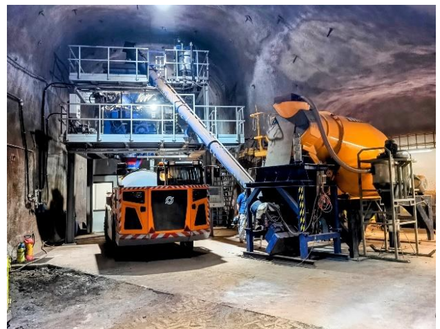
Abb. 10 neue Betonmischanlage der BGE zur Herstellung von Stahlfasernassspritzbeton
