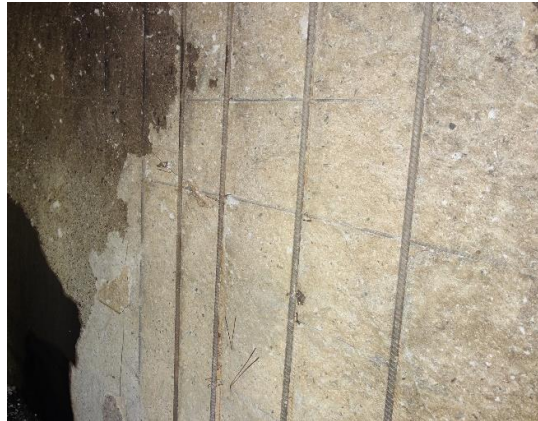
Bild 1: Tiefe Abplatzungen und freigelegte Bewehrung (Bild: Metro)
