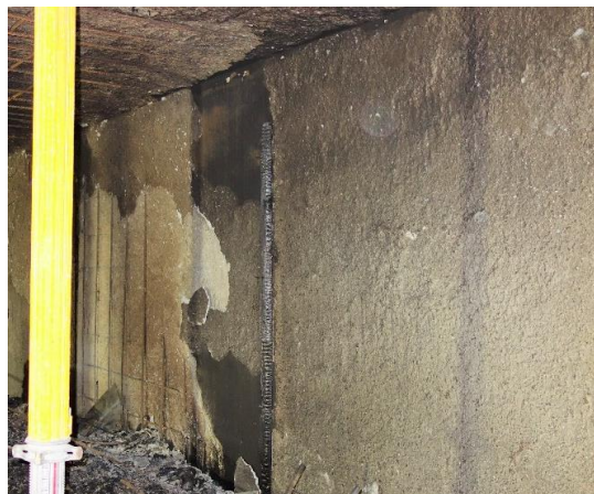
Bild 2: Lokale Abplatzungen und Ablösungen (Bild: Metro)
