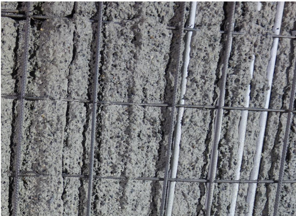
Bild 5: Oberfläche nach dem Wasserstrahlen. Hüllrohre für Kabelstränge wurden kaum unbeschädigt. (Bild: Metro)
