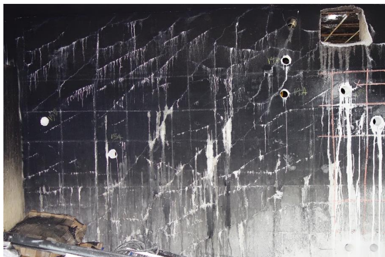
Bild 3: Rissbildung auf der feuerabgewandten Seite. Ebenso sichtbar sind Bohrkernentnahmestellen rechts, und abgeschliffene Stellen für die zerstörungsfreie Prüfung links. (Bild: Metro)
