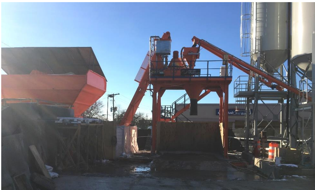
Bild 4: Baustellenmischanlage Plymouth Tunnel (Montagezustand)
