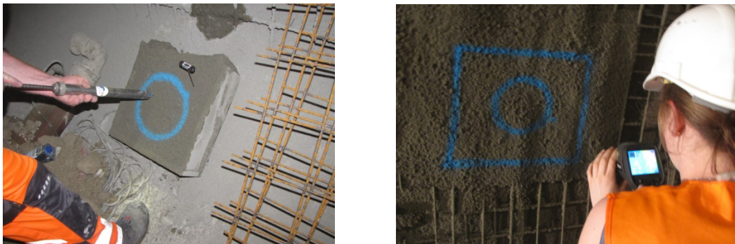
Bild 6: Frühfestigkeitsprüfung (< 1h) mittels Penetrationsnadel an einer Spritzkiste (links) und Temperaturmessung mittels Thermografie an der Spritzbetonschale (rechts)
