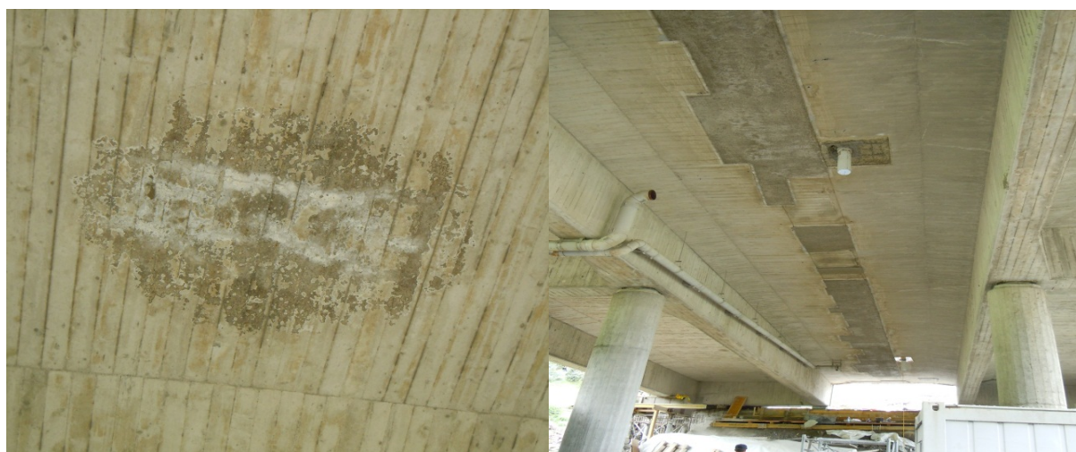
Bild 1: Chloridinduzierte Schäden und Instandsetzung mit kunststoffmodifiziertem Trockenspritzmörtel einer Brücke bei Innsbruck
