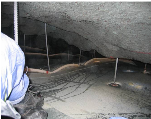
Bild 10: Hohlräume hinter PE Schaum Platten (Bild: BASF)
