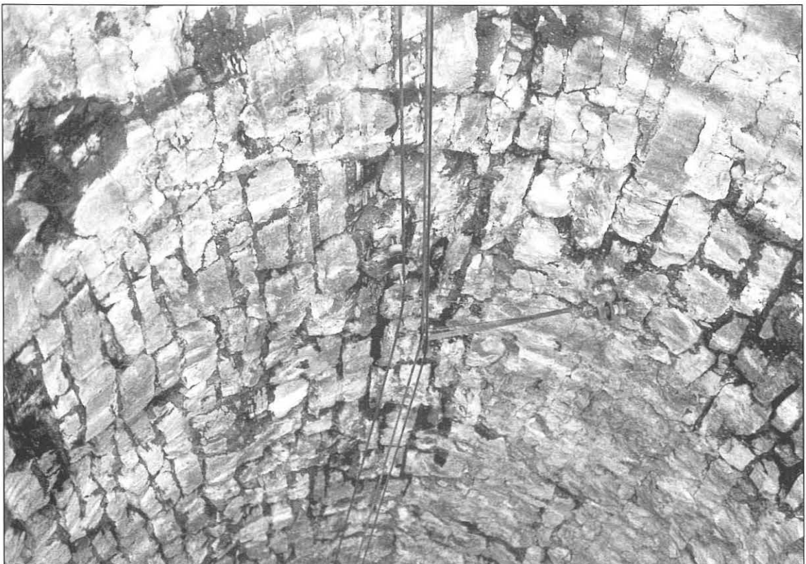
Bild 5: Schadhafte Natursteinmauerwerk im Gewölbe des Tunnels Val d'Ingeniustria, 1996
