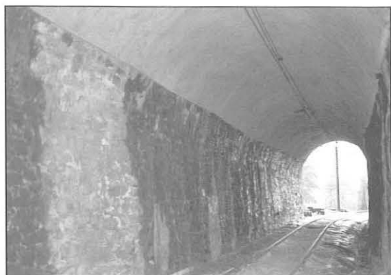
Bild 8: Nur im Gewölbe zur Abdichtung ausgekleideter Abschnitt des Tunnels Frana di Corcapolo, 1998 (ausgeführt 1971)
