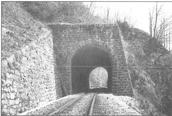
Bild 3: Tunnel Ruinacci vor der Instandstellung, 1970
