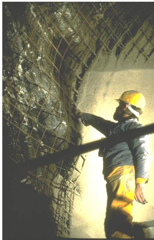
Bild 4: Spritzbetonschatten infolge zu schnellen Erstarrens des Spritzbetons.
