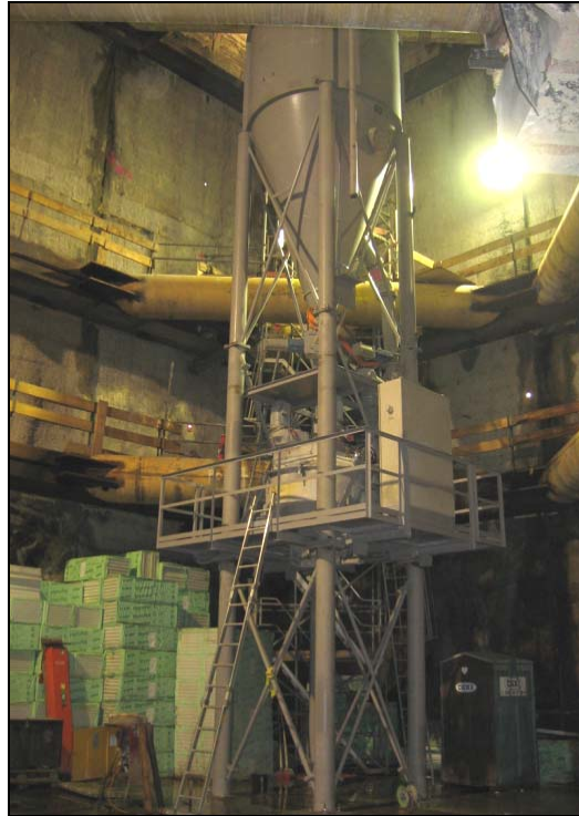
Bild 2: Silo für Trockenbeton mit unterhalb angeordneter Mischeinheit (Bild: ARGE U55)
