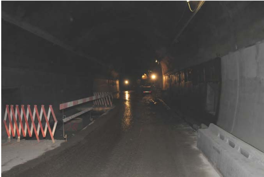
Bild 3: Fahrbahn-Kabelkanal Nordröhre BA2, 09/08 (Bild: ARGE)
